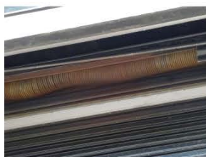
3 施工前の芯棒です。錆びたり、動きが硬くなっていたりします。
